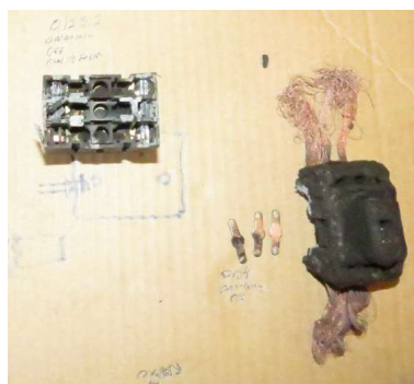
Skader på kontakter for ekstern forsyning
