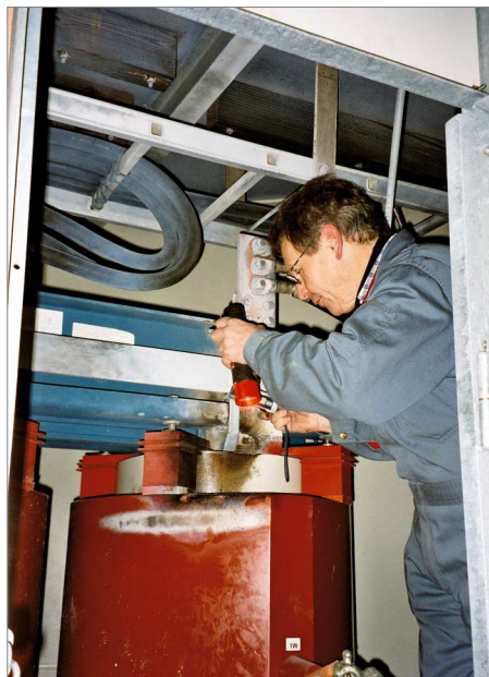
Inspektion af skade på transformere i mølle 20
