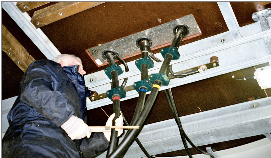
Kablerne som går op til transformeren skal flyttes lidt ned for at passe til den nye transformere fra ABB.
