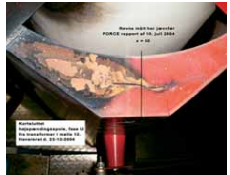
Transformeren, der kortslyttede dagen før jul sidste år præcis på det sted, hvor ultralyd-undersøgelsen havde forudsagt en revne. (Foto: Jens H. M. Larsen)
